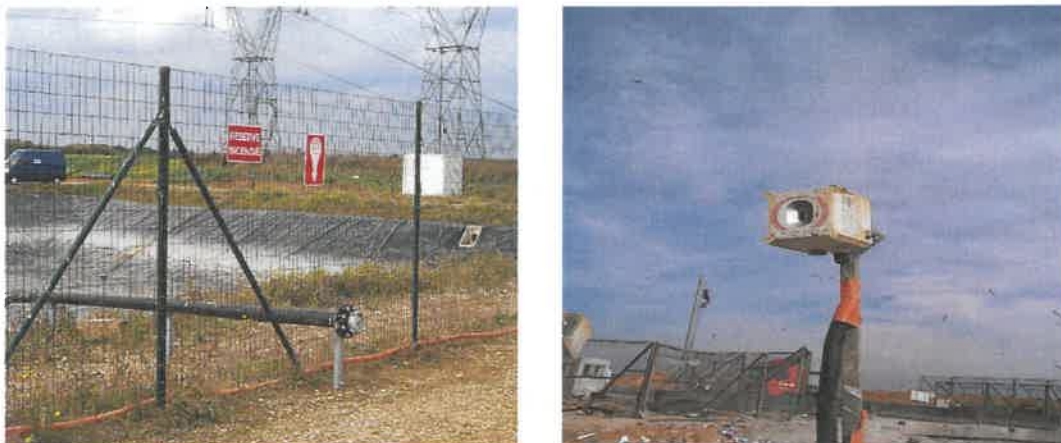
Photo 14 – Point de pompage pour les sapeurs-pompiers et détecteur de départ de feu
