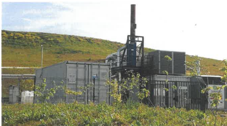
Photo 5 – Moteur de valorisation électrique
