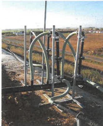
Photo 4 – Station de réglage puits biogaz
